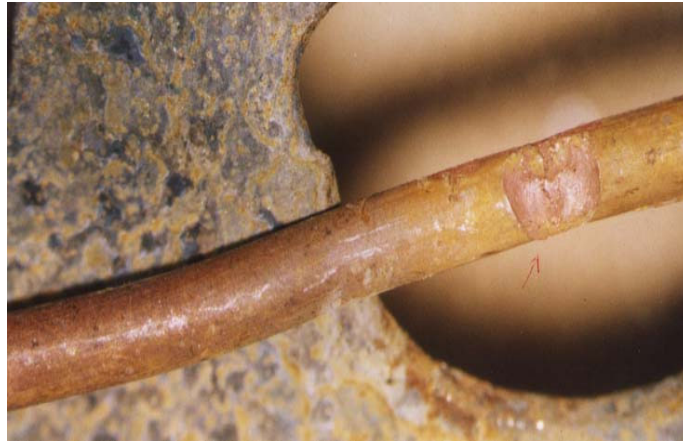
사진 3.4 천장의 배선박스과 전선간에 발생된 누전으로 형성된 단락흔
