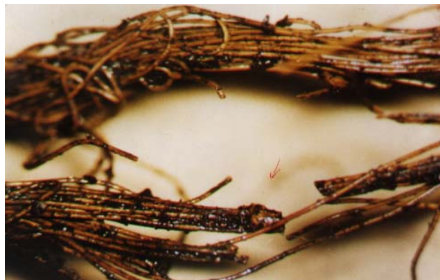
사진 3.2 코드 연결부분에서의 불완전 접촉으로 발열된 흔적 (미세한 단락흔)
